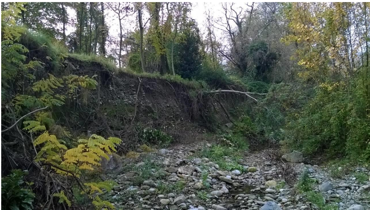
Foto 4 - fenomeni di erosione spondale
