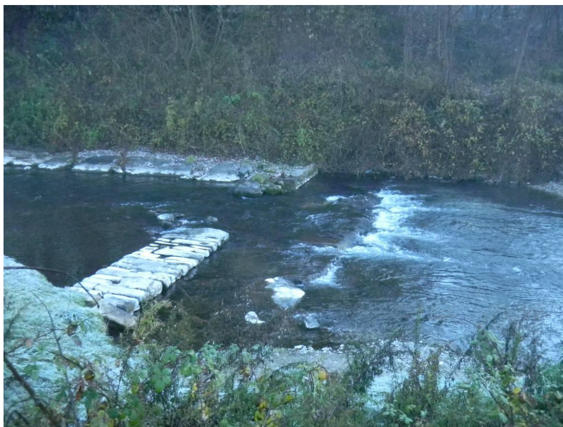
Foto 3 – torrente Cuccio soglia da ripristinare
