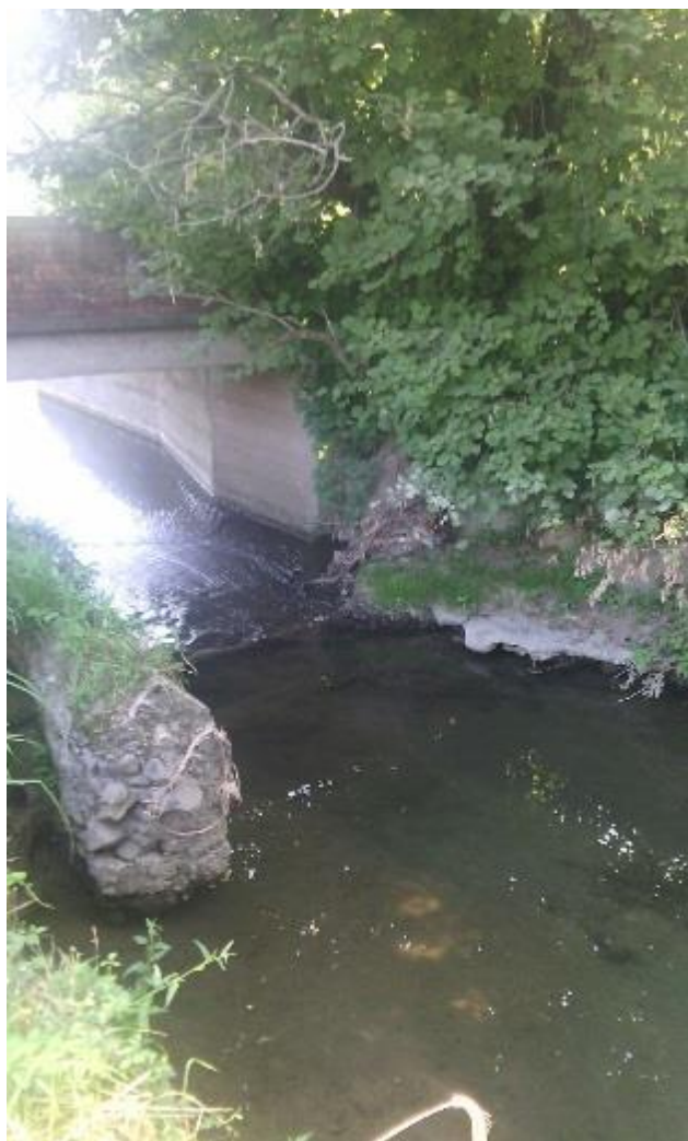
Fig. 7 – erosione in prossimità del ponte sul torrente Tolsera
