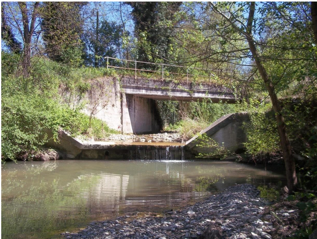
Loc. casone – accumulo di materiale in prossimità dello sfioratore
