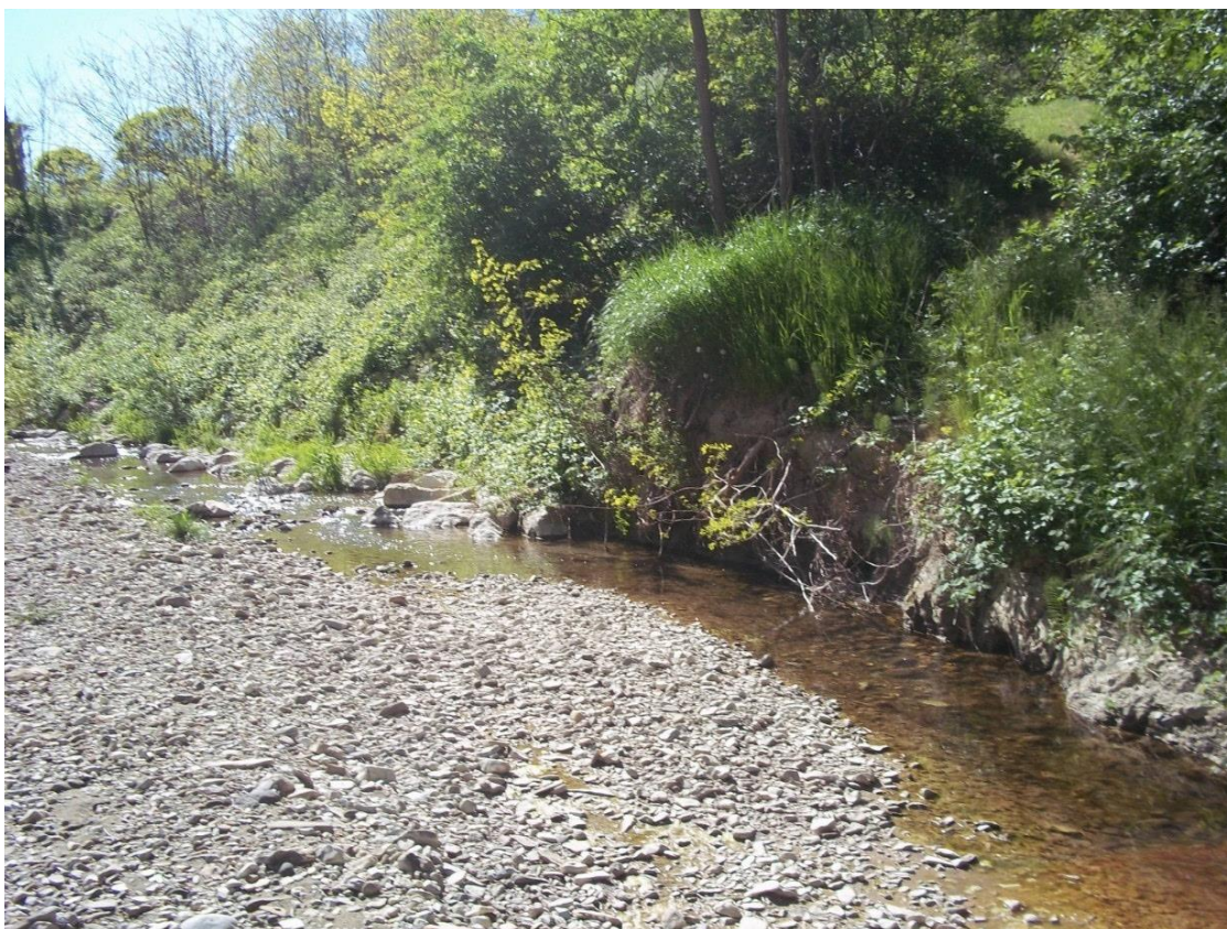
Loc. Palazzina – fenomeni di scalzamento al piede interessanti la scogliera in massi
