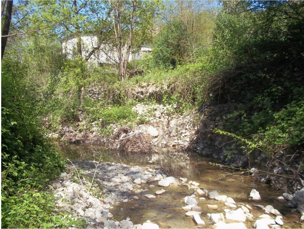
Loc. Casone – gabbionata in sponda destra idraulica in stato di dissesto strutturale
