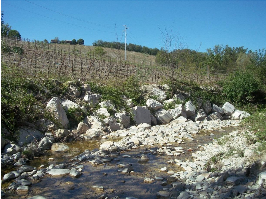
Loc. Casone - Scogliera in massi con fenomeni di scalzamento e distacco di elementi
