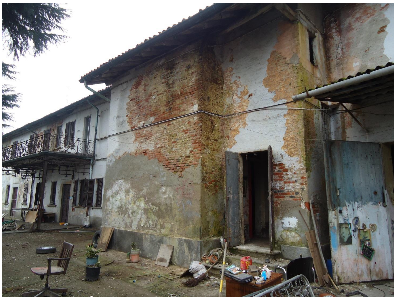
Fig.3 - Vista della facciata della Chiesa dal cortile interno alla cascina (visibili crolli e infiltrazioni d'acqua)
