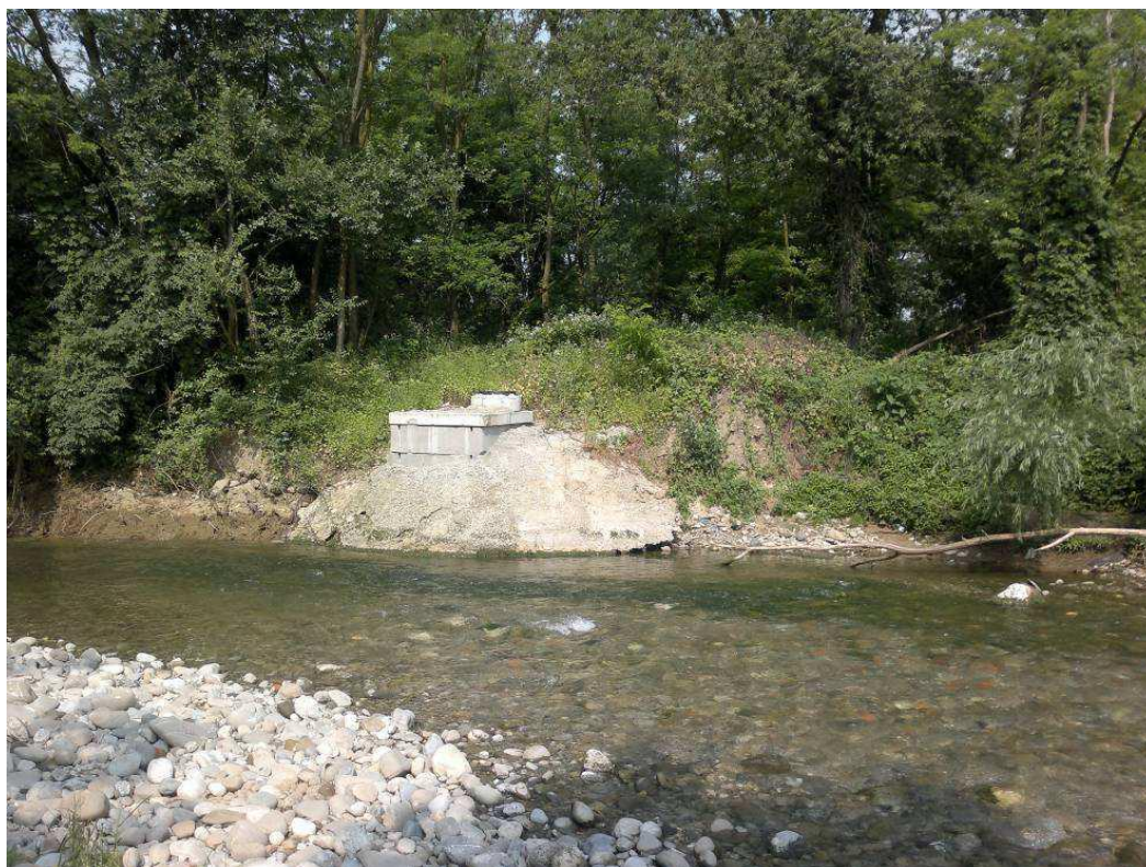
Foto 2. Vista del tratto eroso, con la cameretta di sbocco del sifone fognario.
