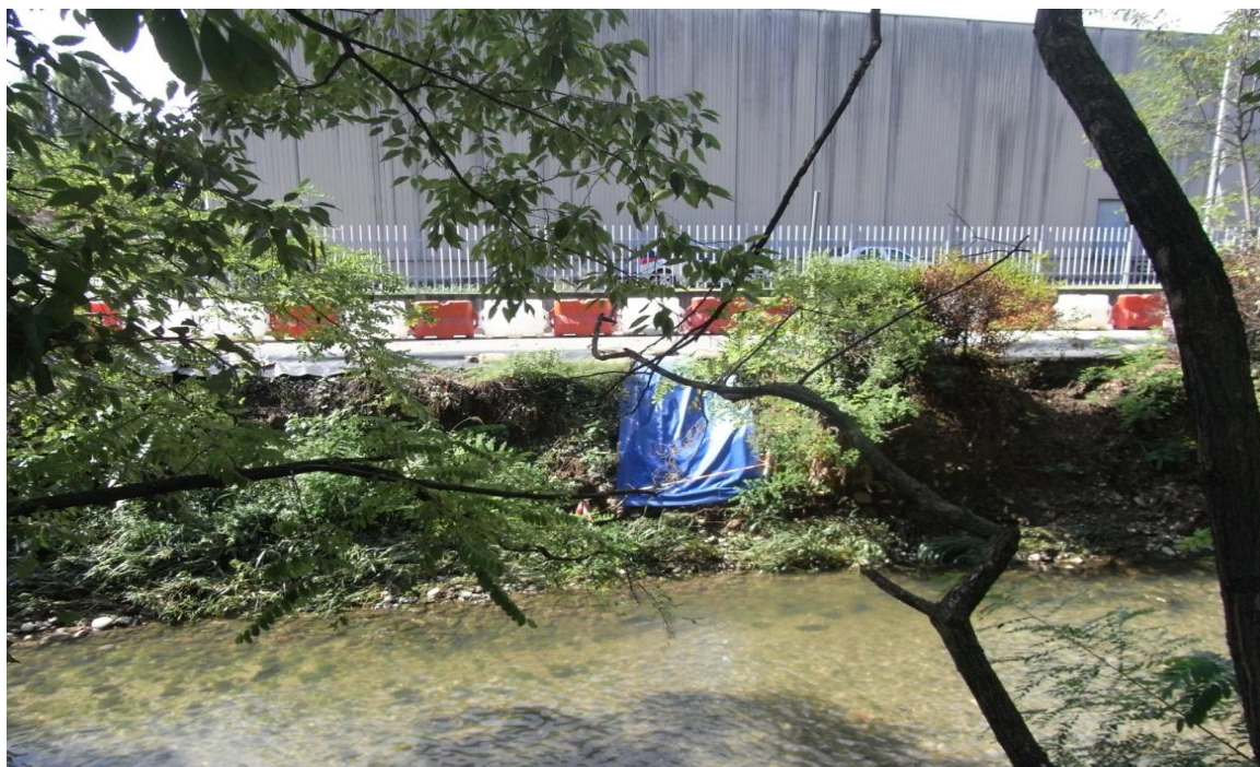
Foto 5. Erosione spondale lungo la strada che costeggia il torrente Molgora.
