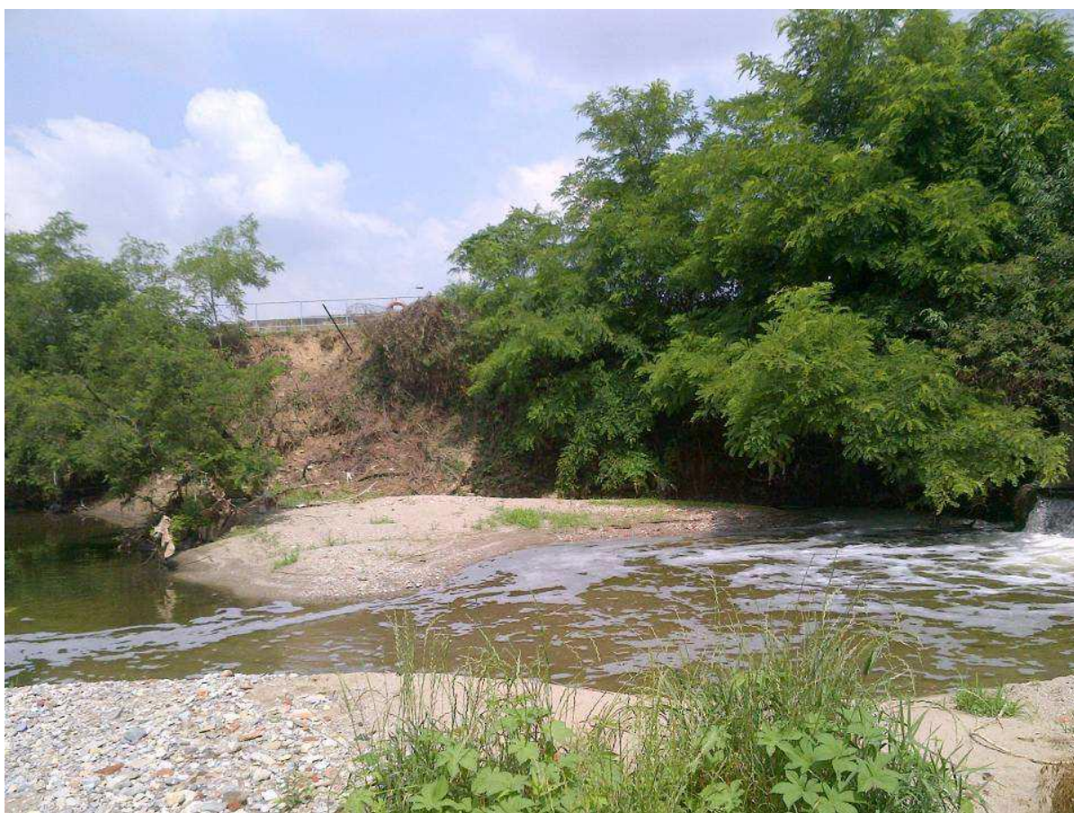
Foto 1. La sponda in erosione all'interno dell'area del depuratore vista dall'interno del T. Molgora: è visibile il parapetto di protezione della vasca di clorazione.
