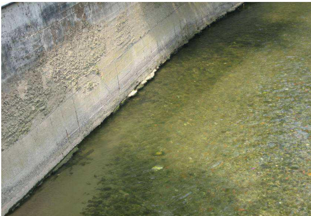
Foto 10. Erosione al piede di un tratto del muro spondale a valle del ponte di S.M. Bambina.
