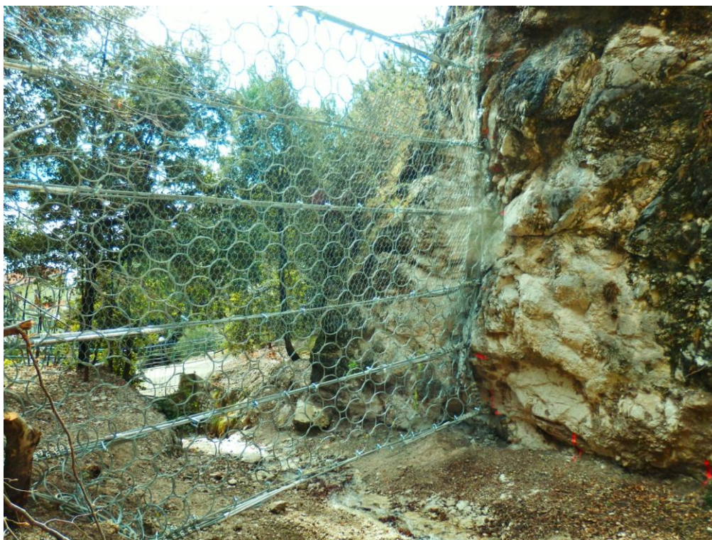
Figura 2 - Barriera di contenimento n. 1 installata in alveo appena a monte della strada di accesso al villaggio vacanze "La Limonaia" – vista da monte.
