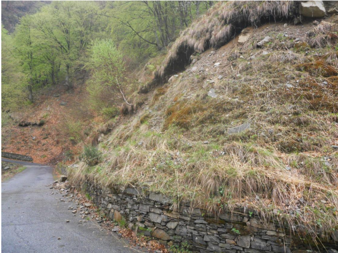
Fig. 3 - muretto a secco sormontato da detriti parzialmente ricoperti da vegetazione
