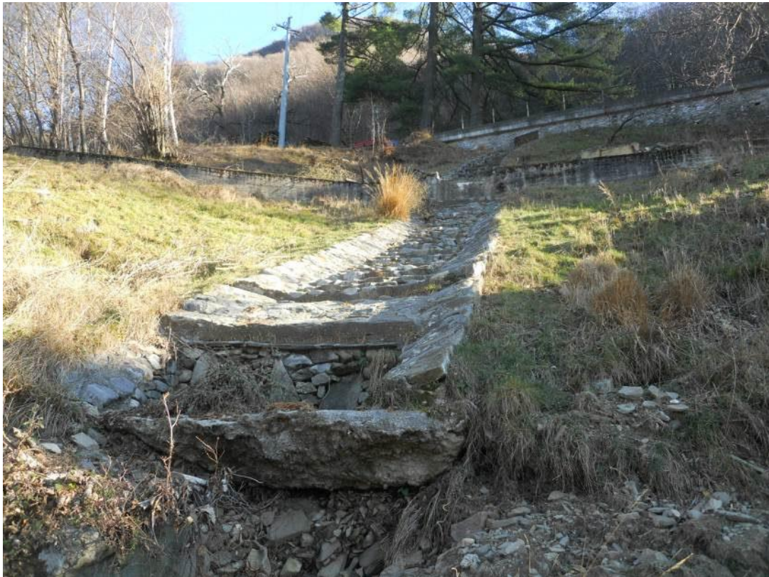
Figura 1 - particolare dell'erosione sulla parte finale del tratto regimato nella prima zona
