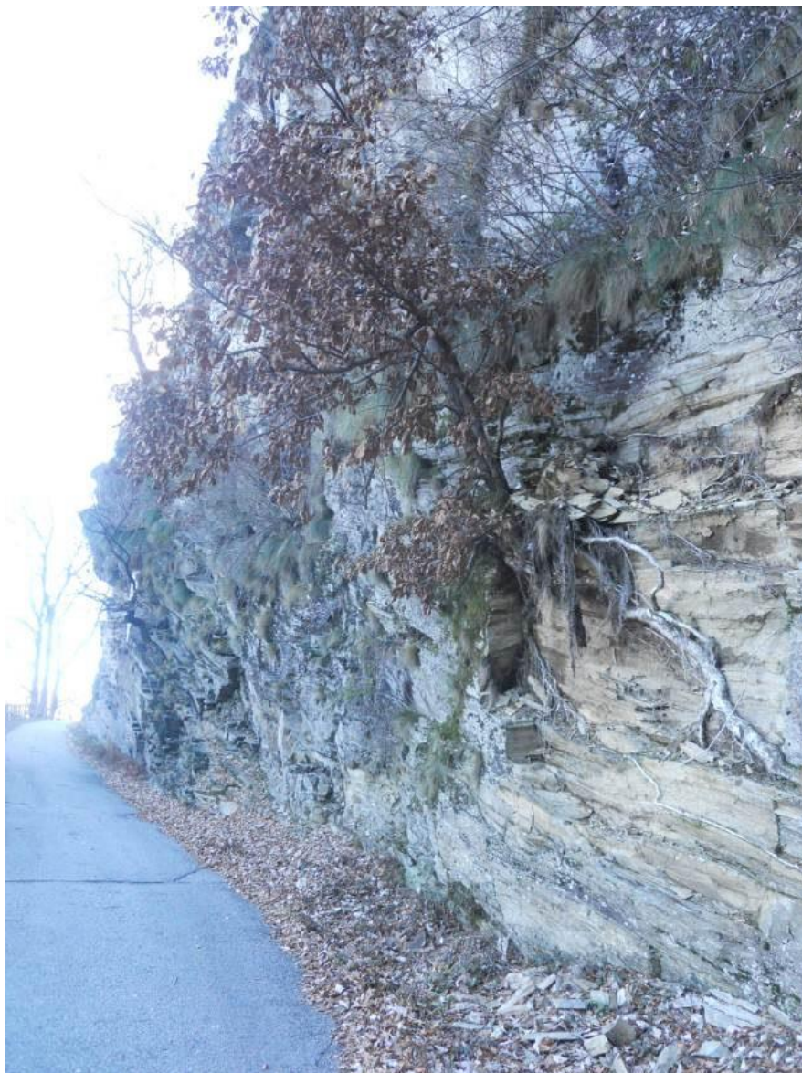
Fig. 7 - parete rocciosa subverticale a picco sulla strada. Evidente il materiale detritico a bordo strada
