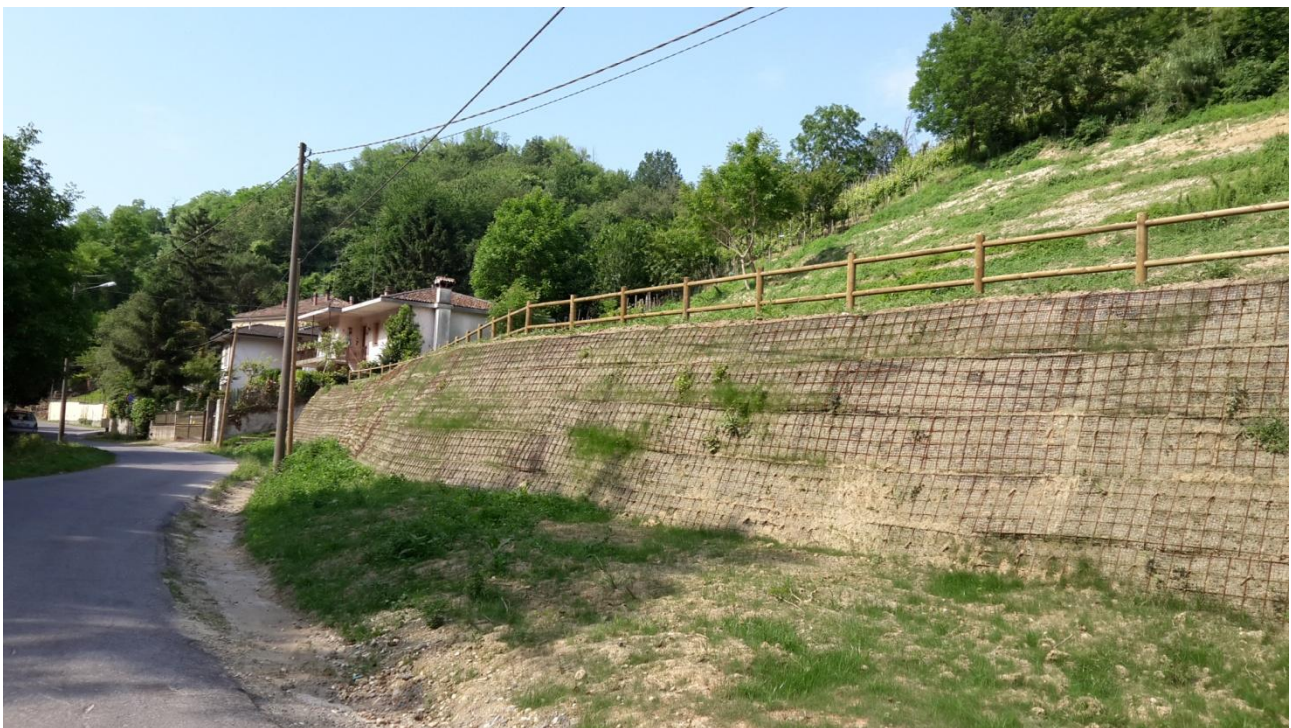
1) Consolidamento del corpo di frana.
