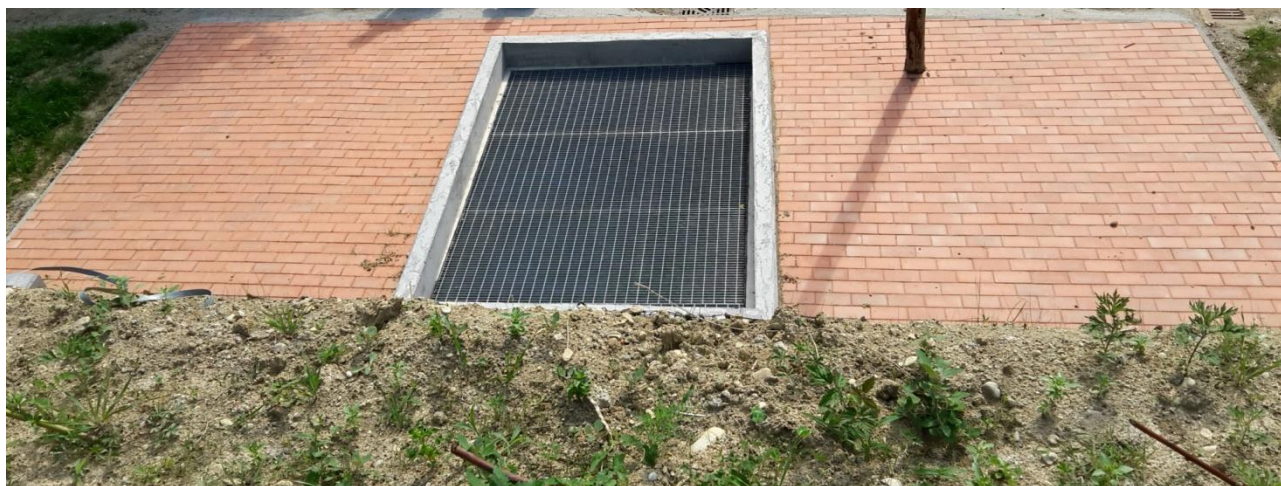
4) Vasca di raccolta (vista dalla sommità della terra rinforzata) e griglia ispezionabile.
