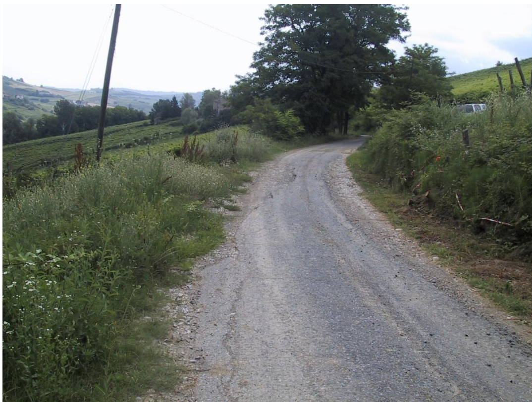
Prima dell'intervento - movimento franoso e dissesto piano stradale - immagini
